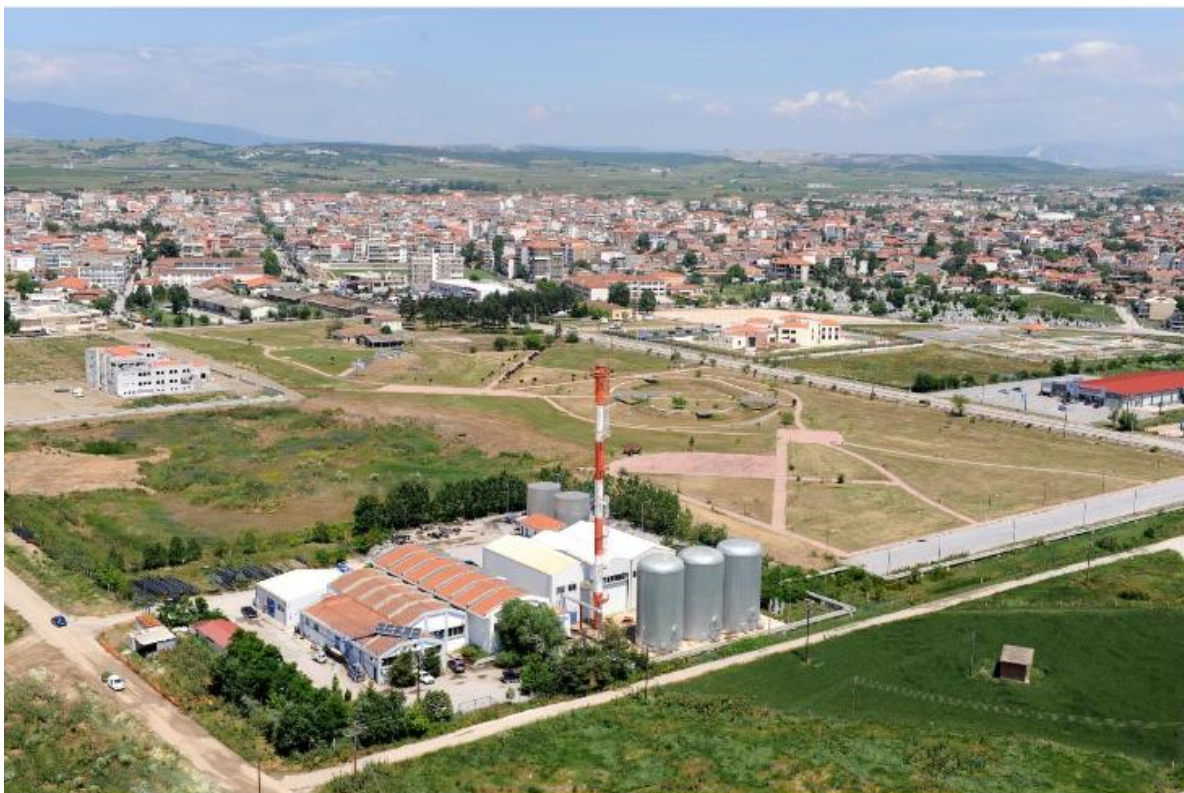
Εικόνα 1.2: Κεντρικό Αντλιοστάσιο Δημόσιας Επιχείρησης Τηλεθέρμανσης Πτολεμαΐδας (ΔΕΤΗΠ) στη νότια είσοδο της Πτολεμαΐδας 2
