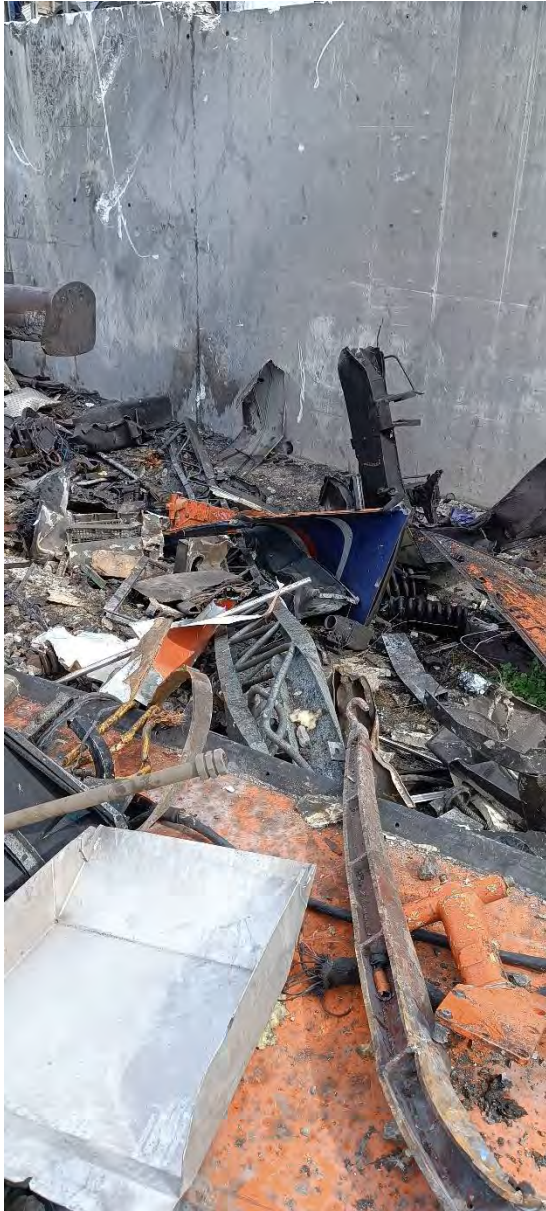
Φώτο 65 Καταστροφή του μεταλλικού πύργου συγκράτησης καλωδίων
