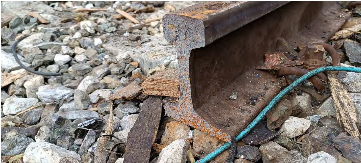
Φώτο 63 Ψαθυρή θραύση της γραμμής καθόδου πλησίον σημείου συγκόλλησης
