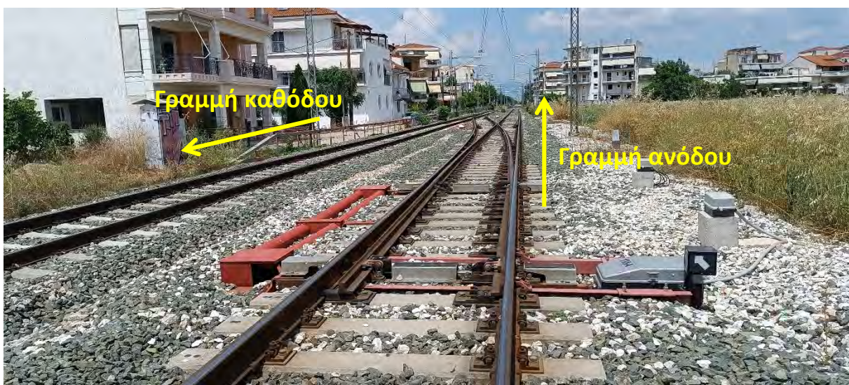
Φώτο 10. Κλειδί 118 σε θέση παρακαμπτηρίου
