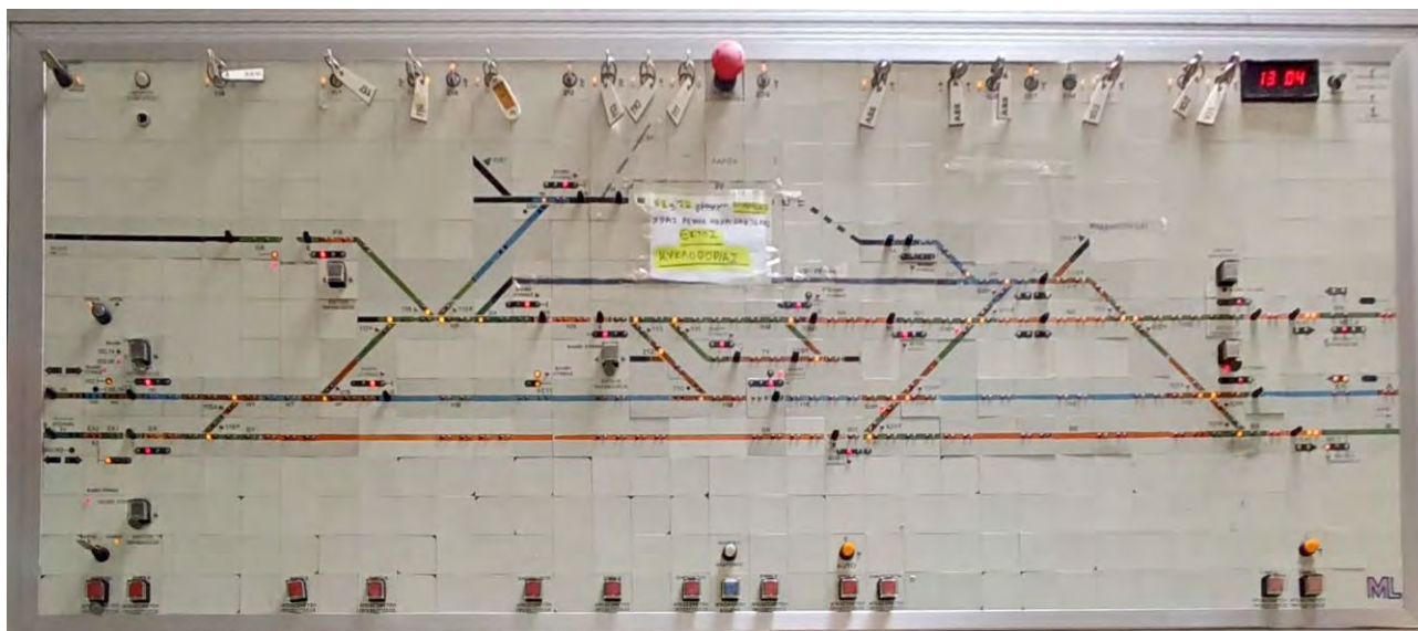
Φώτο 8. Τοπικός Πίνακας Χειρισμών Σταθμαρχείου Λάρισας
